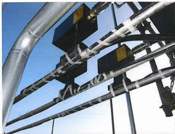
オートトレースヒータ施工例(電源部)
