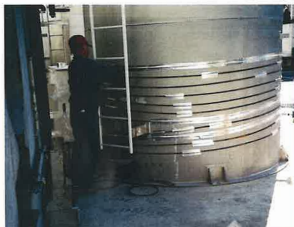
オートトレースヒータ施工例(タンク)
