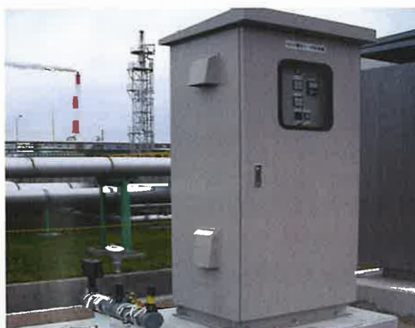
ヒータ制御盤
